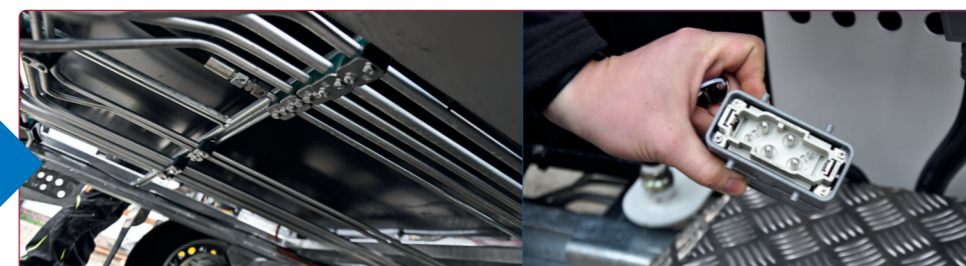
FEST VERROHRTE, WARTUNGSARME LEITUNGSFÜHRUNG
